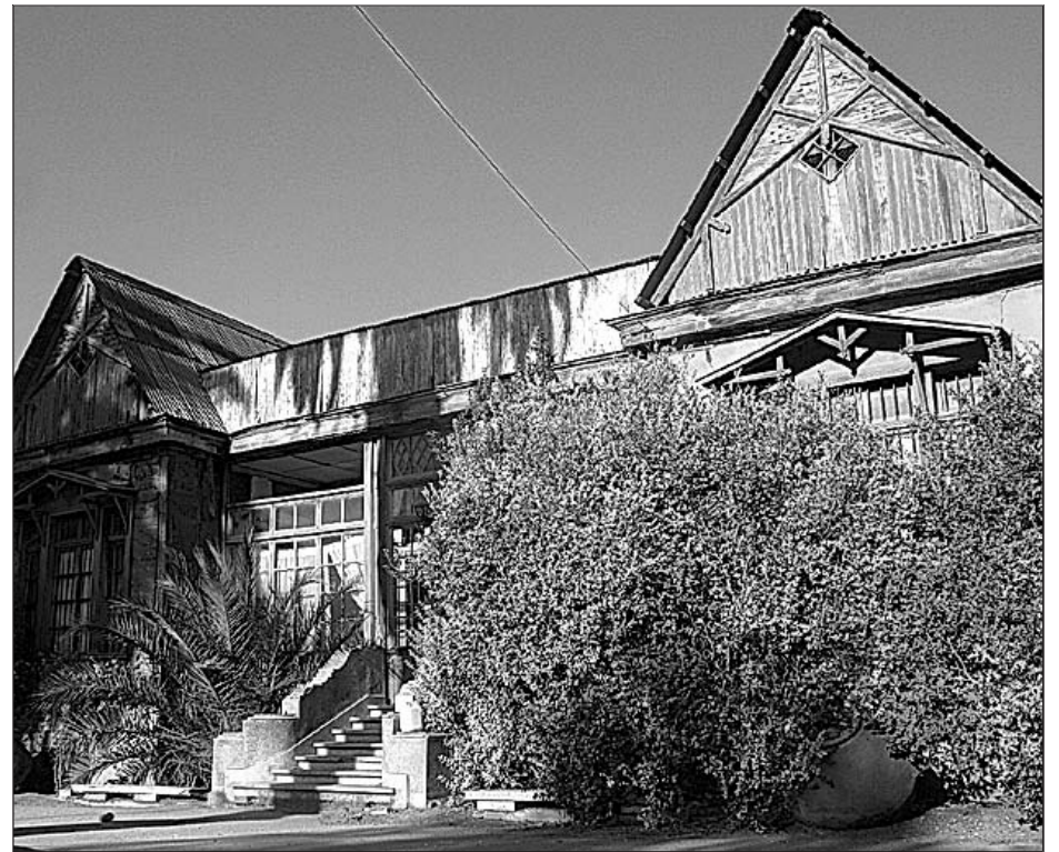
Antes tenía tres pisos, con el terremoto de 1985 perdió el segundo y el tercero; con el terremoto del 27 de febrero sufrió heridas graves en su estructura pero reparables.
