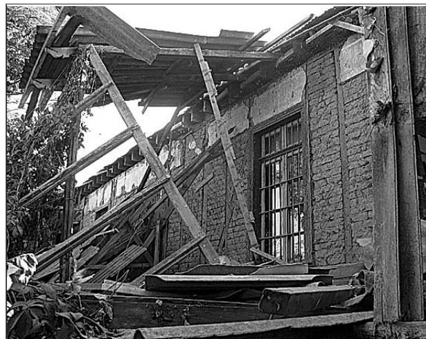
Parte de los pasillos laterales se vino abajo, por dentro la casa perdió algunos muros, sin embargo su estructura central sigue firme.
